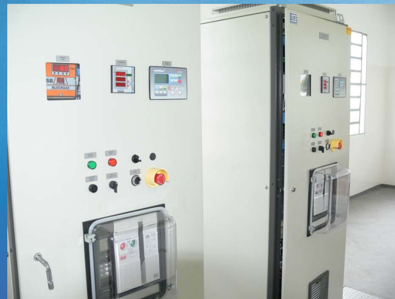
Painéis de controle
